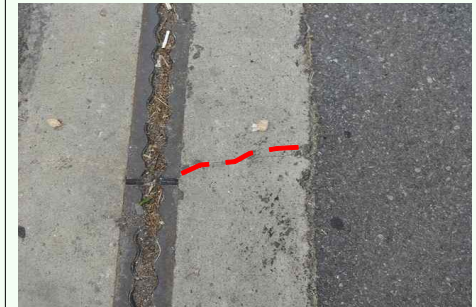
사진4 -A2 신축이음 후타재 균열
