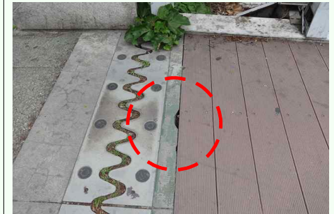
사진4 - 신축이음 후타재 파손
