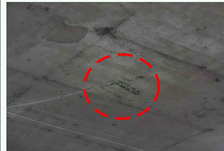
사진3 - S2 바닥판하면 긁힘
