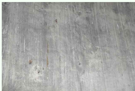
사진5 - A2 교대 망상균열 및 열화
