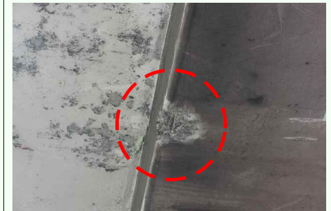
사진4 - S2 바닥판하면 파손
