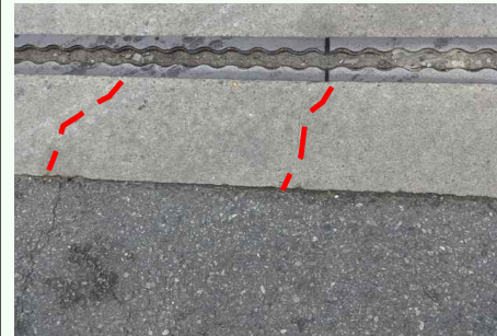
사진3 -A1 신축이음 후타재 균열
