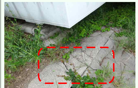
사진8-A2 교대 법면 파손
